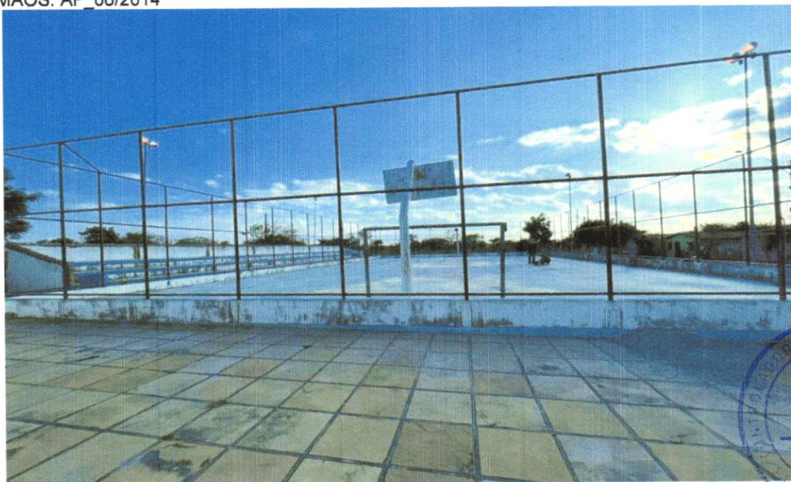
FOTO 16 – INSTALAÇÃO DE REFLETOR SLIM LED 200W DE POTÊNCIA, BRANCO, FRIO, 6.500K,AUTOVOLT, ,ARCA G-LIGHT OU SIMILAR.
